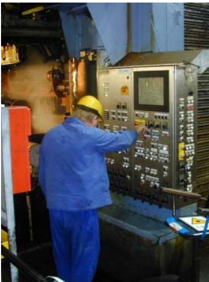
Steuertafel im Walzwerkbereich. Foto: Alstom
